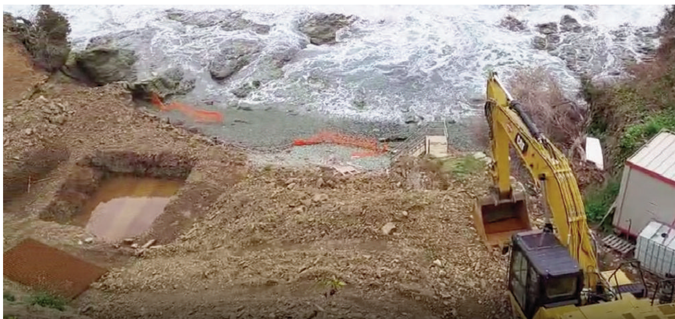
Chantier de construction de la promotion Pietramare à Petranera, commune de San Martinu Di Lotta
